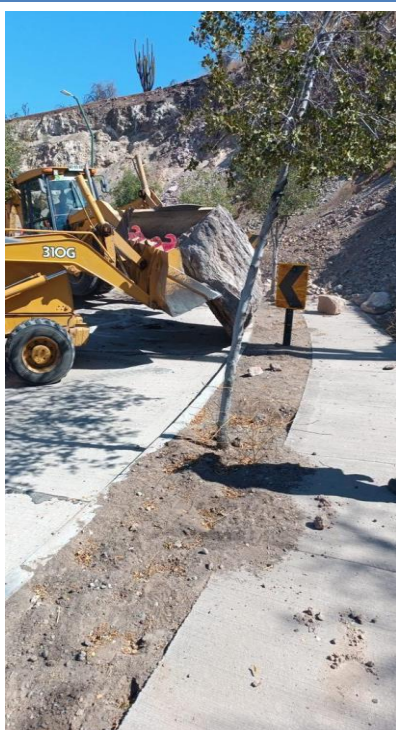
Imagen 1: Día 21-03-2023 caída de roca en el sector de Las Canteras, en condominio La Reserva
